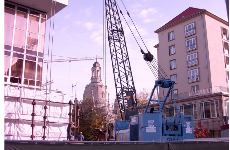
HBr ZKV – Zentrale Kälteversorgung Neumarkt (DREWAG)
