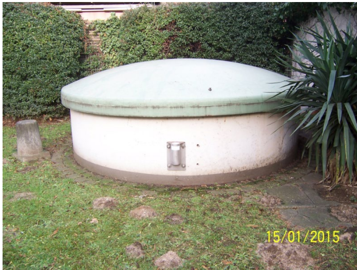
HBr Duisburg Aldenrade zur Grundwasserniederhaltung
