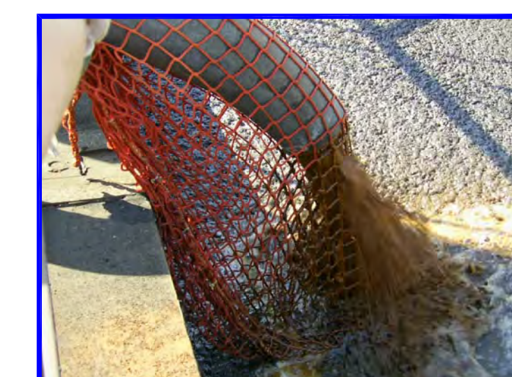
GW-Ableitung beim Molchen
